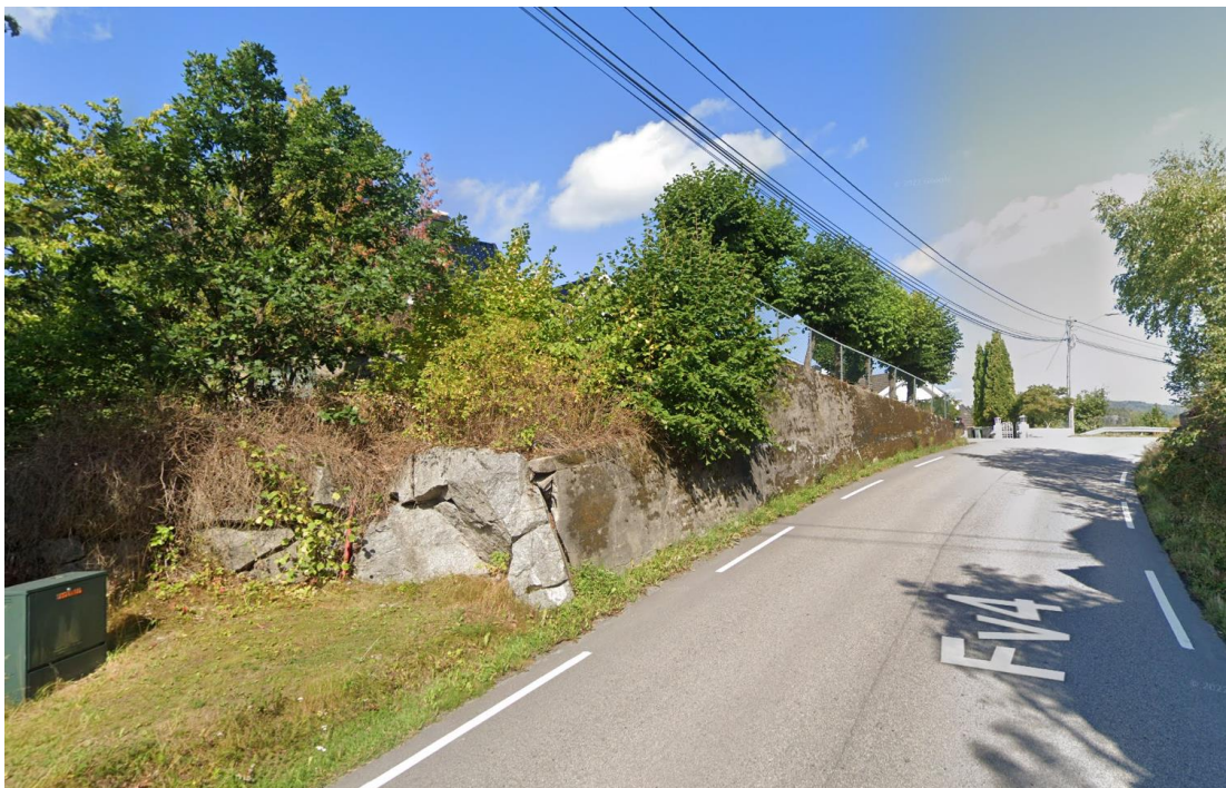
Figur 27: Bilde av eksisterende tørrsteinsmur på høyre side av vegen, med berg i bakkant. Bilde fra Google Street View.
