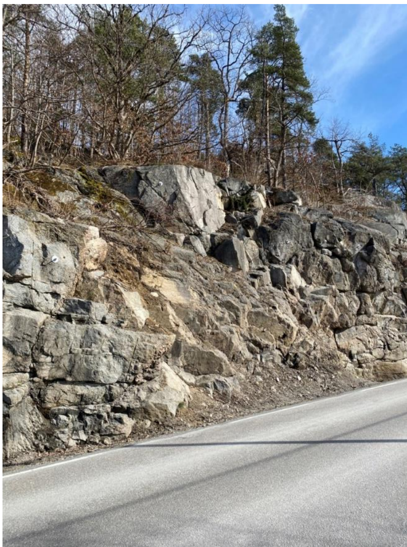
Figur 7: Tett oppsprukket bergmasse i eksisterende skjæring ved planlagt bergskjæring B4.
