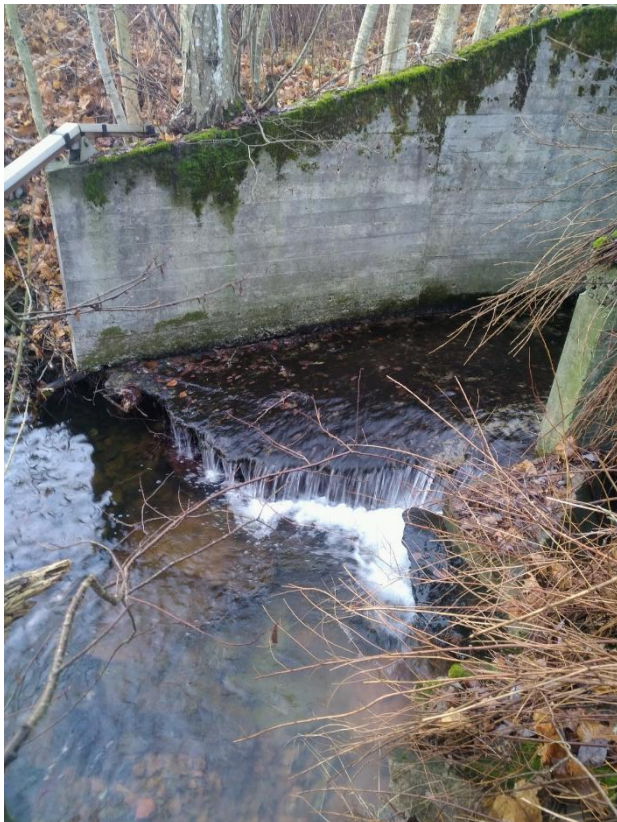
Figur 6-11 Eksempel på støpt bunnplate under bru hvor erosjon nedstrøms har gitt overheng og oppgangshinder for ål. Bunnplata er videre helt flat som ved normalvannføring gir svært liten vandedybde, noe som gjør den vanskelig passerbar for ørret. Garilla i Numedalslågen.
