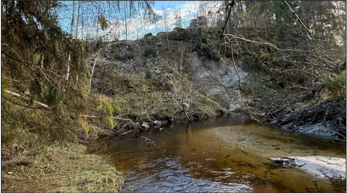
Figur 2-5: Herregårdsbekken, Interessepunkt 8. Erosjonsutsatt yttersving mot næringstomt. Fyllmasser, med aktiv erosjon og eksponering av eroderbare masser.
