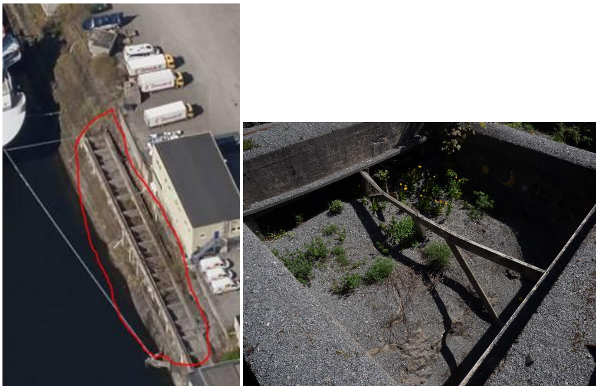
Figur 6: Omtalt kranfundament fra flyfoto og bilde av grusfyllinger i fundamentet med innslag av naturlig flora ved markmalurt.
