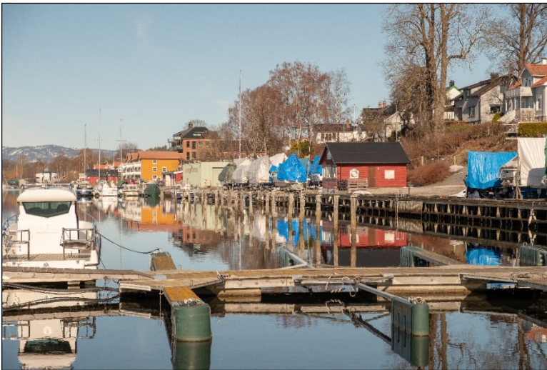
Figur 15: Bilde sett nordover mot Porsgrunn motorbåtforening, før kaifronten kollapset og raste ut i elva.
