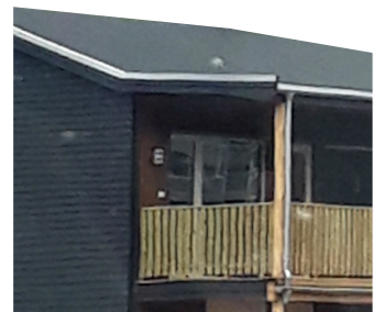
I dette tilfellet burde taket over balkongen ha vært en forlengelse av hustaket og ikke bygget opp med annen vinkel.
