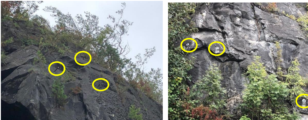
Figur 8. Eksisterende boltesikring i høy skjæring. I foto til venstre er det synlig innstøpte kamstålbolter uten skive (trolig eldst) og til høyre innstøpte bergbolter med skive (trolig av nyere dato). Foto Olav Bache-Hansen.
