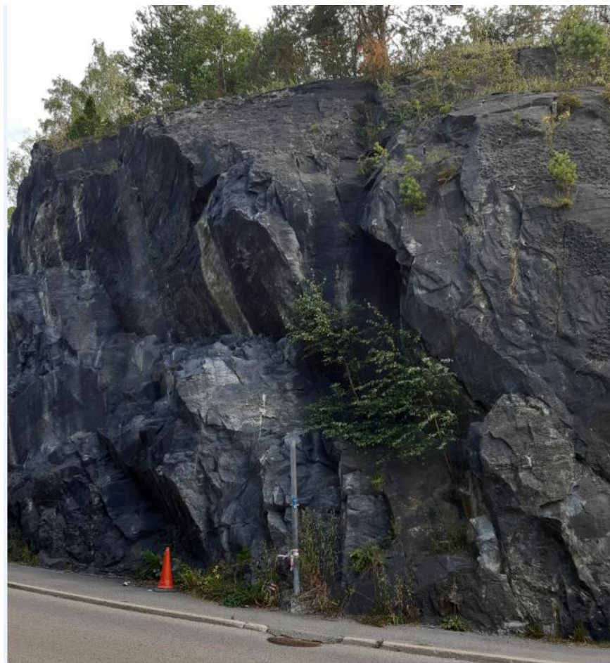
Figur 6. Foto inn mot høy skjæring i innersvingen. Det er ikke synlig sikring fra gatenivå, men vanskelige fotoforhold med sterk sol og skygge i skjæringen, gjør at evt. sikring kan være vanskelig å se, jfr. 8. Utfall fra steile sprekker med fall inn i skjæringen er lett å se. Overheng som dannes ved slike utfall er ikke synlig i tverrprofiler fra vegmodell.
