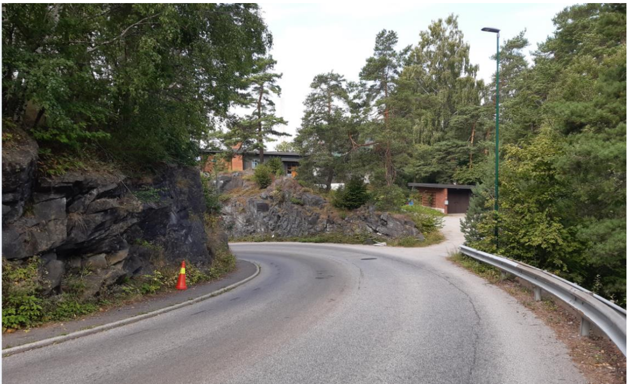
Figur 4. Foto mot innkjøring til Torskebergvegen 11. Behov for ny støttemur på utsiden av vegrekkverk. Det er mulig å etablere adkomst for anleggsmaskiner fra innkjøringen til nr 11 og tilbake langs foten av eksisterende mur. Anleggsarbeider i skråningen nedenfor bør ikke skje på vinterhalvåret pga. fare for utglidning og velting av maskiner.
