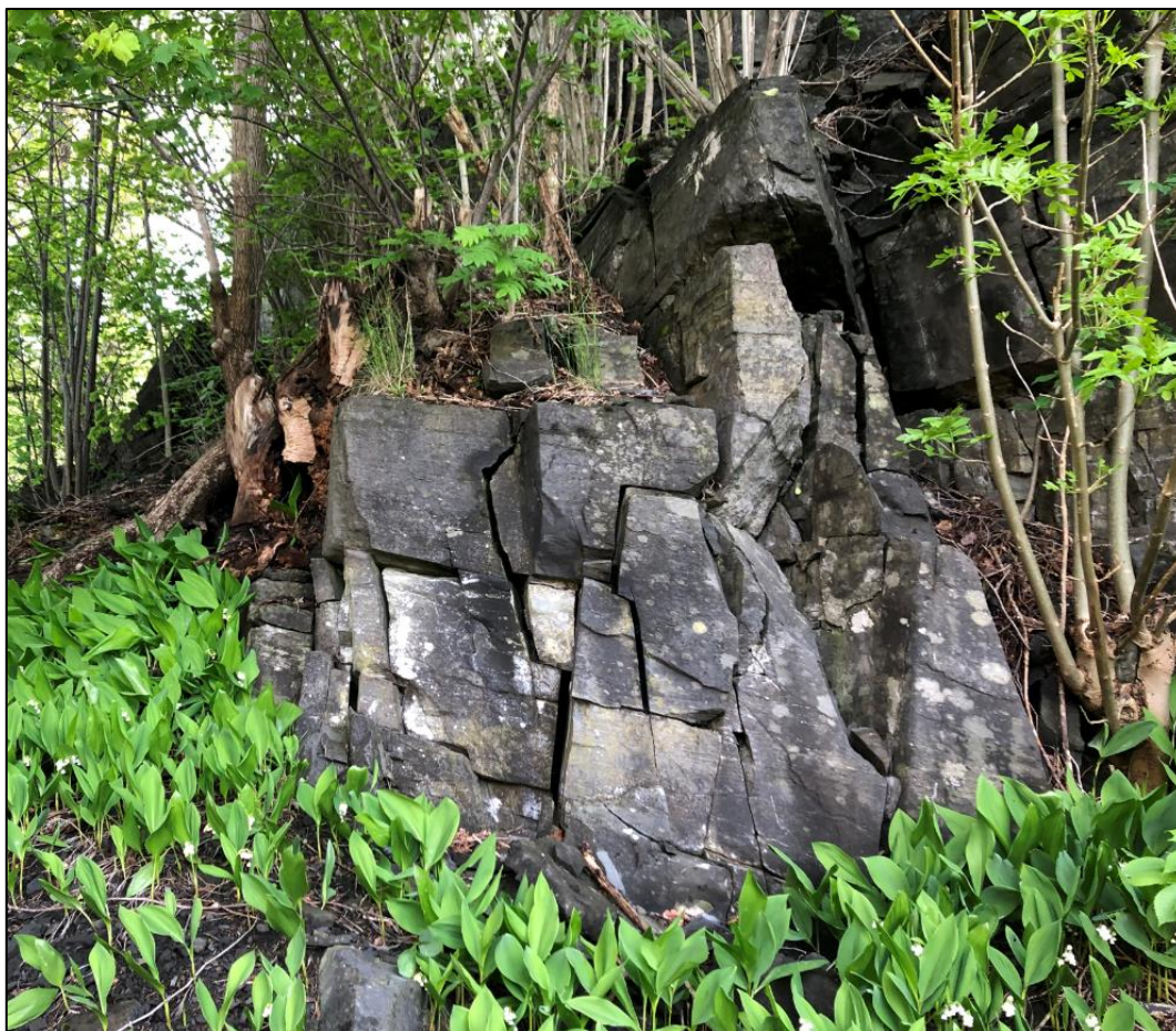
Figur 6. Tett oppsprukket berg. Hovedsprekkesettet følger lagningen og faller 15-20 grader mot øst. Bildet er tatt mot nord.
