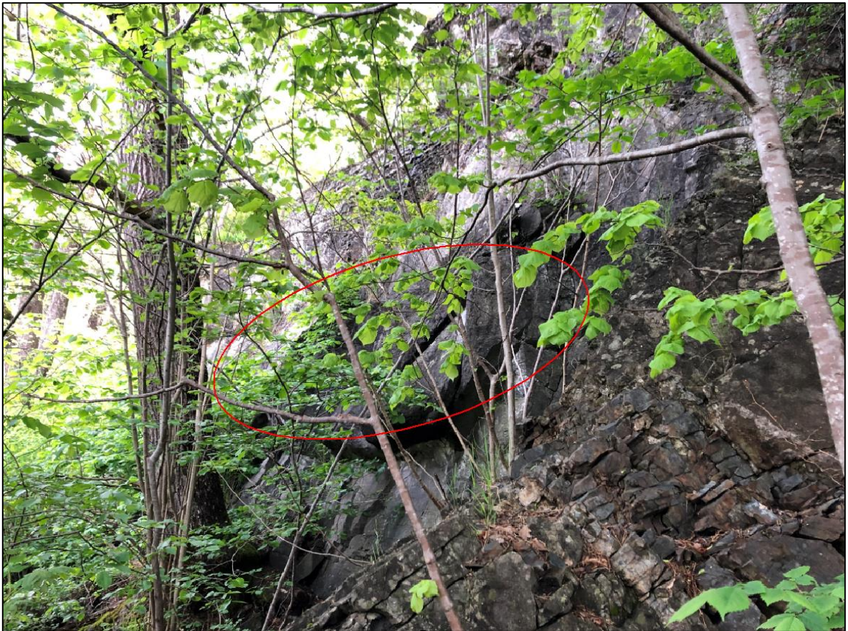
Figur 10. Flere avløste og mulig ustabile steinblokker i den nedre brattskrenten mot byggeområdet indikert med rød sirkel.
