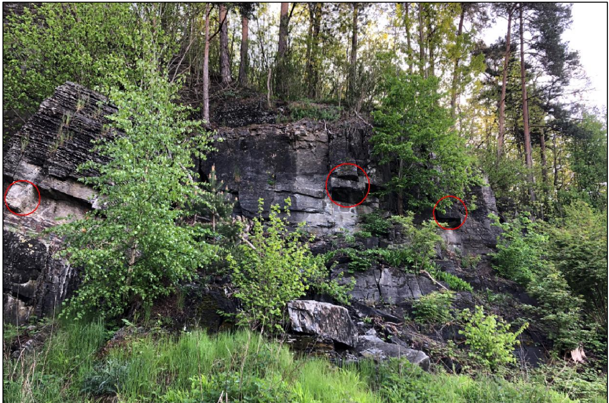
Figur 9. Avløste og mulig ustabile steinblokker i den nedre brattskrenten mot byggeområdet indikert med røde sirkler.
