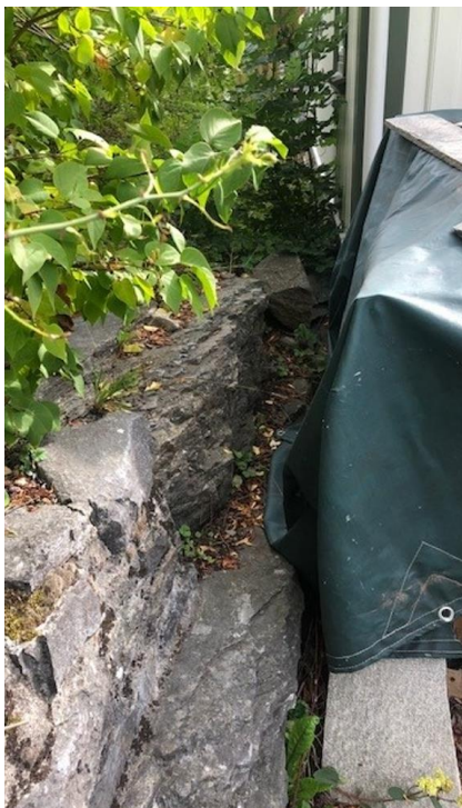
Observert fjell i dagen ved nordøstre hushjørne
