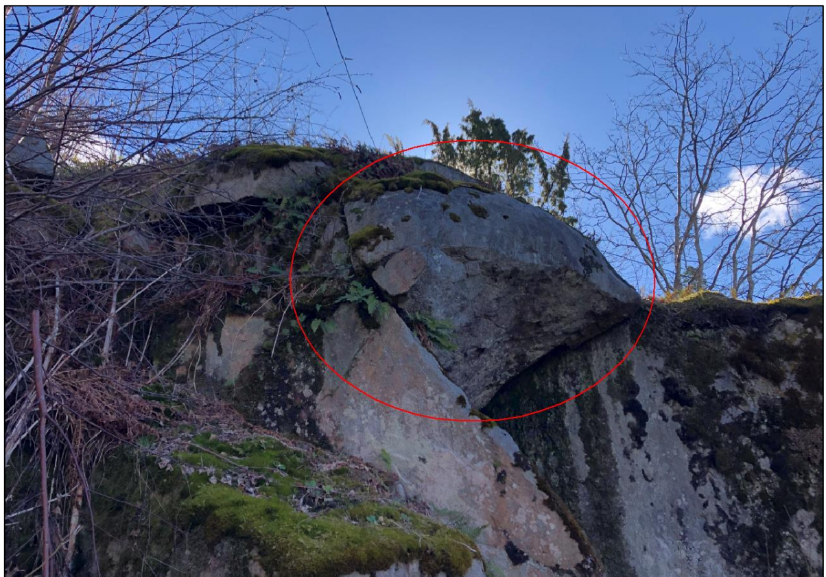
Figur 11. Avløst steinblokk som ligger an mot sprekk som faller ut av skrenten.
