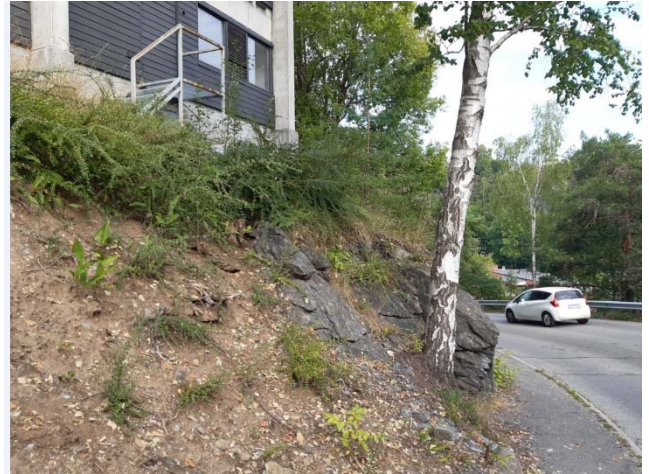
Figur 3. Det er ikke plass til utvidelse på venstre side nedenfor gangbro uten ekstra kostnader for sikring av berg og løsmasser under fundament for bygget
