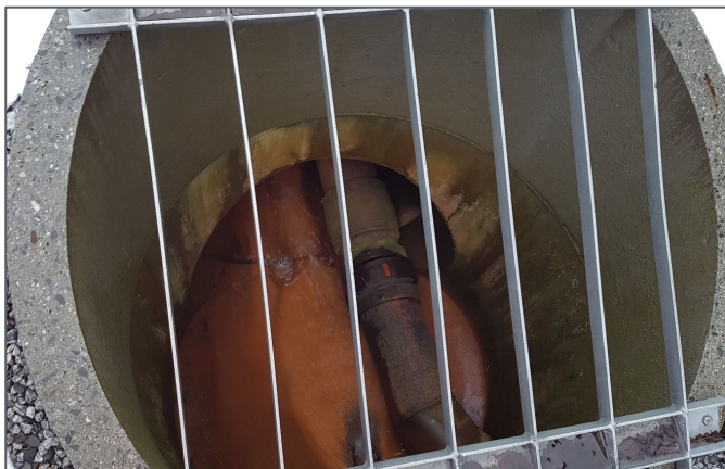
Figur 20: Foto av inntaksum til OV1000BET oppstrøms Massedeponi16. Spillvannsrøret markert i Gemini er her synlig. (Gemini).
