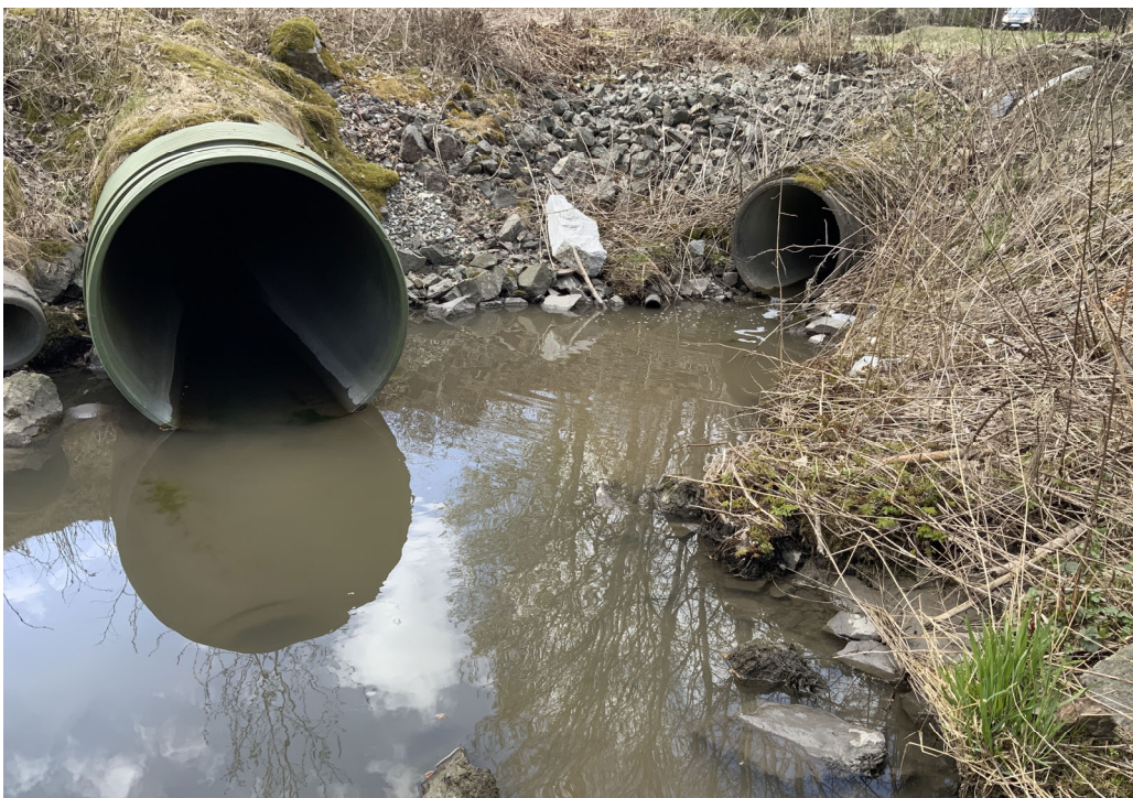
Figur 15. Utslipp av overvann fra vestre del av Moheim næringsområde kommer ut i rør til venstre, ca. 200m oppstrøms Herregårdsbekken. Bekken som drenerer under Porsgrunn utvikling AS kommer ut gjennom røret til høyre i figur (egen kartproduksjon)
