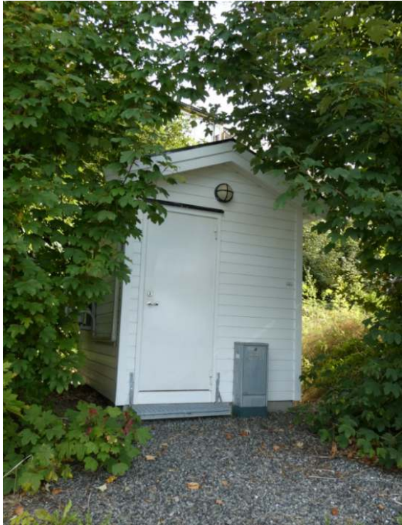
Figur 5- Lite bygg for kobling kabeltv/fiber syd i planområdet.
