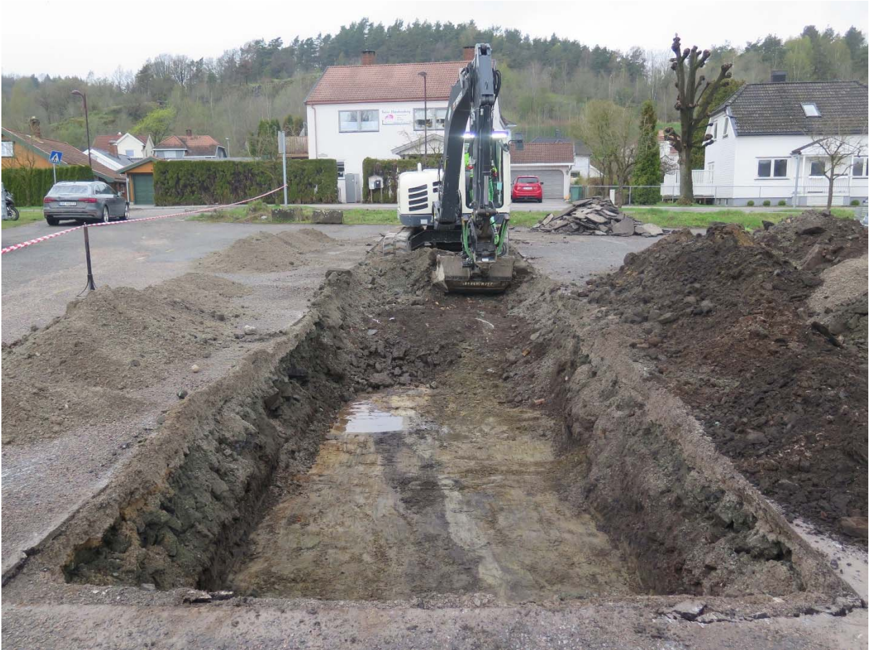
Figur 6. Situasjonsbilde fra sjaktingen. Det mørke feltet midt i sjakta er en drengroft. Legg merke til det mørkebrune matjordslaget som ligger under et tykt lag med pukk og industrislagg. Tatt mot NV.
