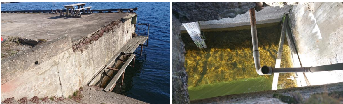
Figur 8: Påstøpt kaifront av armert betong. Høyre foto tatt gjennom hull i betongdekke og viser støpt kaifront med foranliggende steinfylling.
