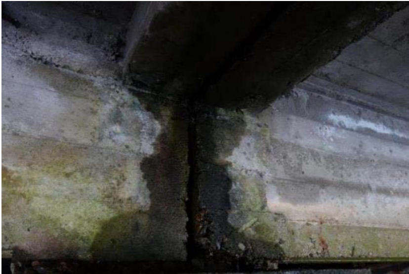
Figur 16: Otät dilatationsfog samt spjälkningskador.
