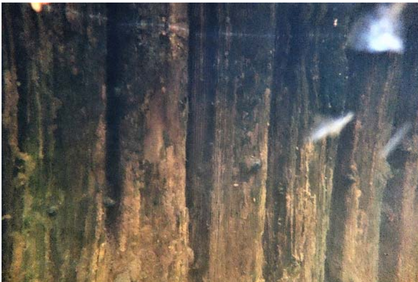
Figur 66: Nedbruten träspont under vattenytan.
