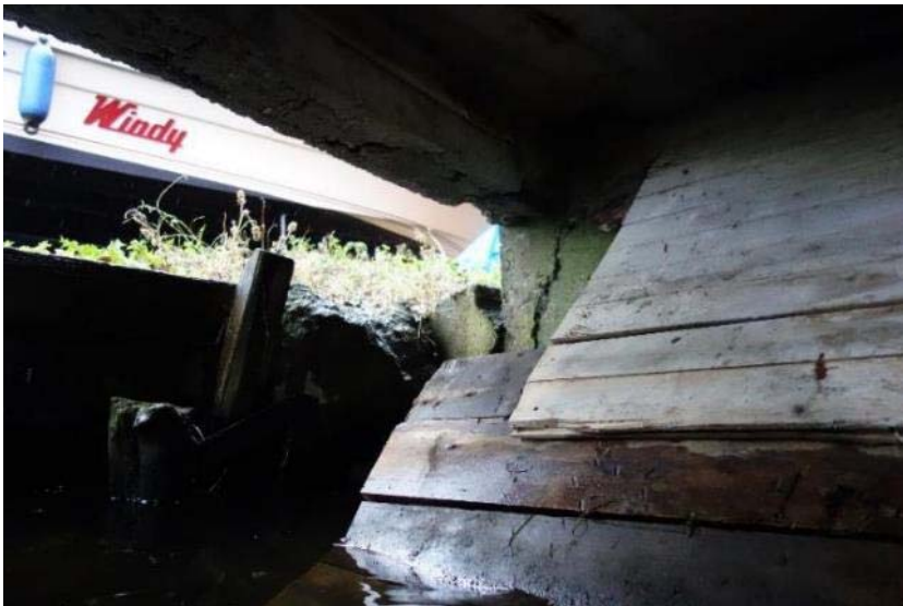
Figur 15: Kvarsittande form samt spjälkningsskador vid norra änden.
