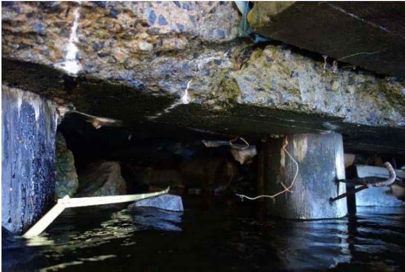
Figur 9: Spjälningsskador och sprickor i betongbalk.
