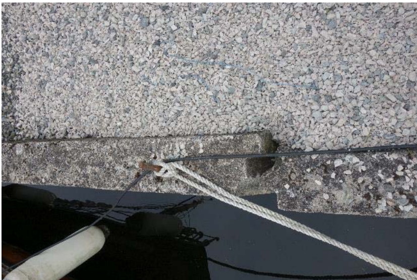
Figur 44: Förskjutning av främre kajelement.
