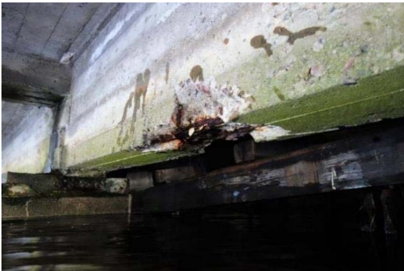
Figur 17: Spjälningsskada med frilagd armering på undersida balk.
