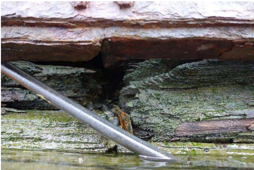
Figur 70: Nedbrutet erosionsskydd under frontmur av betong.
