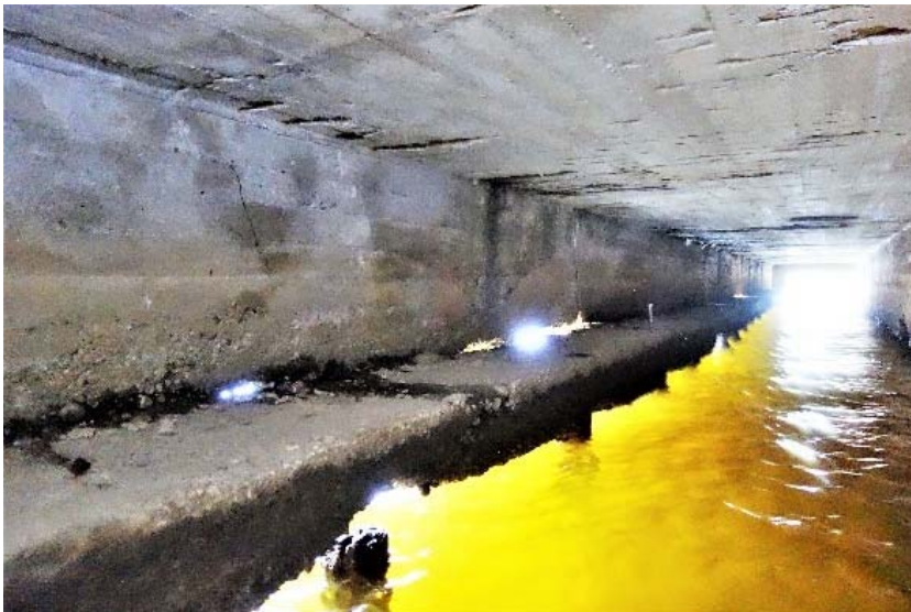
Figur 57: Spjälkningsskador yttre balk.
