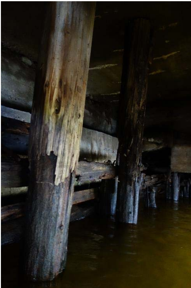
Figur 72: Nedbrutna pålar under kajdäck.
