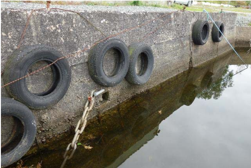
Figur 47: Betongsskador i frontmur.
