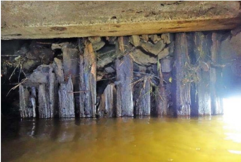
Figur 73: Nedbruten träspont i södra änden av kajdelen.
