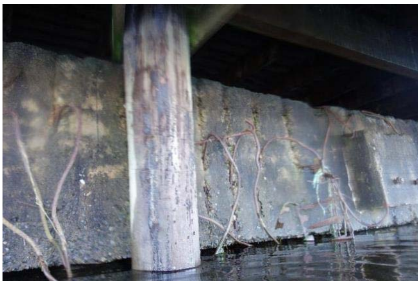
Figur 8: Frontbalk av betong med yttlig nedbockad armering.
