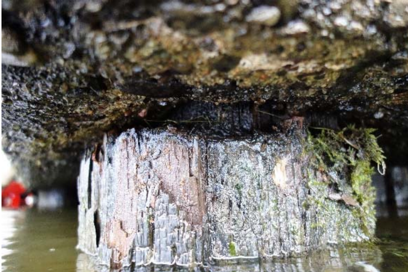
Figur 65: Påltopp med viss nedbrytning av träet vid infästning i balk.
