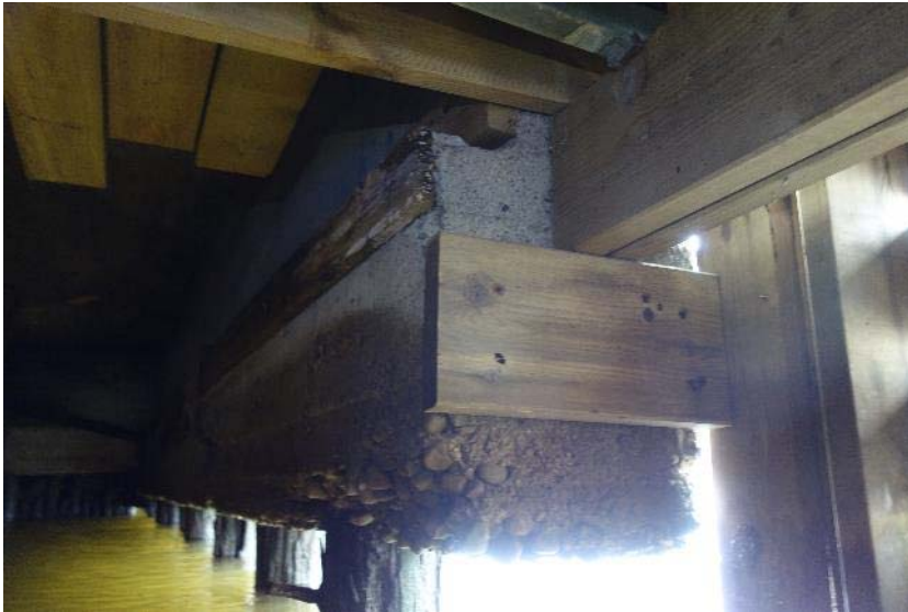
Figur 71: Gjutskadorna i frontbalk.
