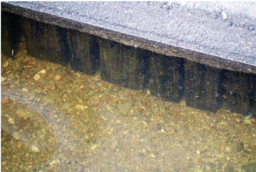
Figur 53: Träspont under kajmur.
