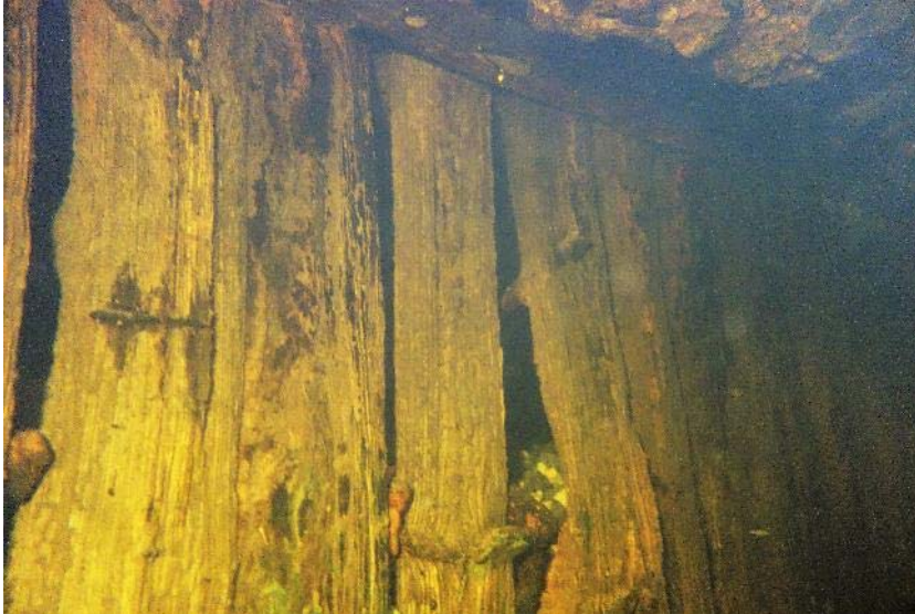
Figur 41: Nedbruten trässpont under vattenyta.
