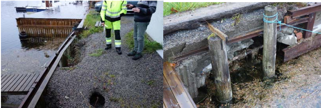
Figur 75: Omfattande sättningsproblem bakom kajvägg av trä.
