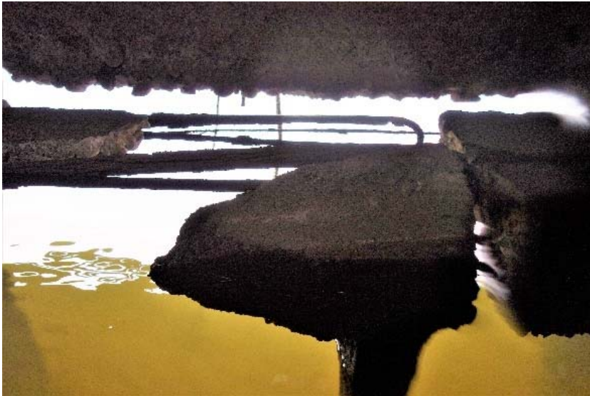
Figur 58: Spjälkningsskador med frilagd armering i yttre balk.
