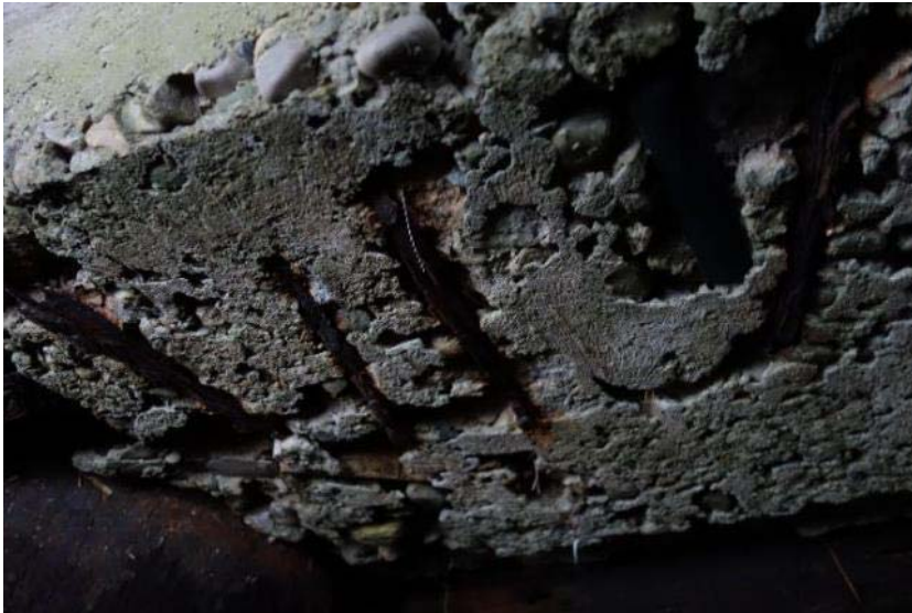
Figur 18: Gjutsår med frilagd armering på undersida balk.
